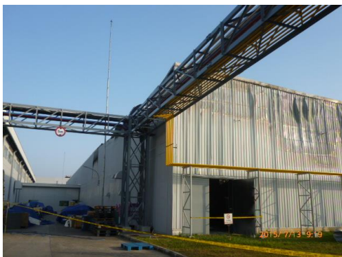
写真 3-1-1 LPガス供給管 (A視)
