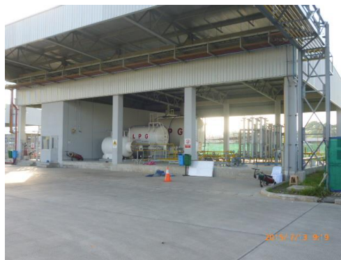
写真 3-1-2 LPガスタンク (B視)
