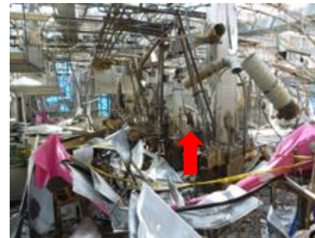
写真 4-2-12 ガス配管移動部 (C 視)
