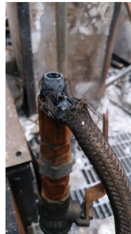
写真 4-2-11 フレキシブルホース破断部 (B 視)
