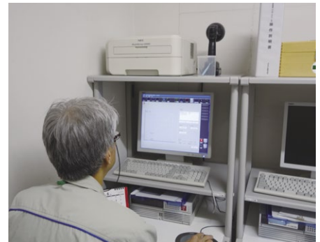
本社ビルのデマンド監視装置
