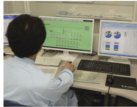
福崎工場のエネルギー監視システム
